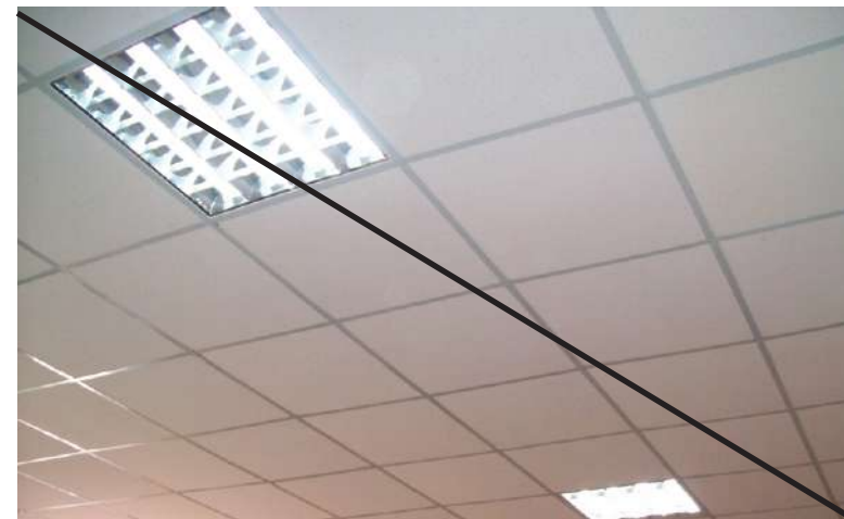
Плохо Открытые направляющие
